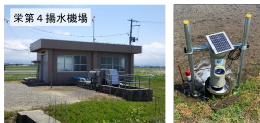
(図-3 栄第4揚水機場と自動給水栓装置)
